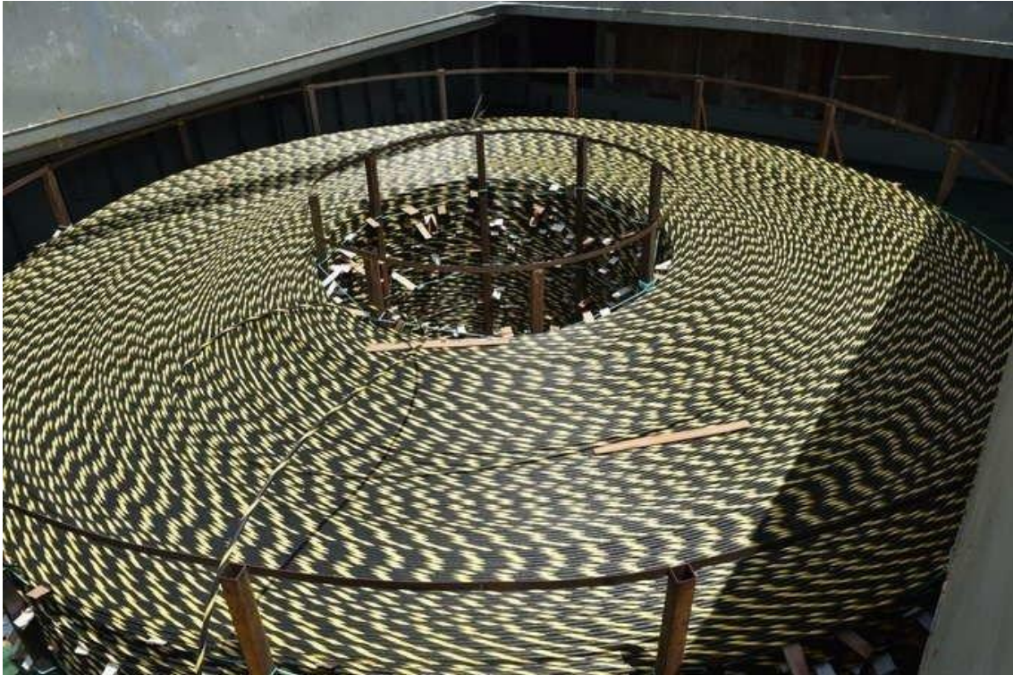
Cabo de fibra óptica preparado para ser lançado nos rios Negro e Solimões – FOTO: Comando Militar da Amazônia
